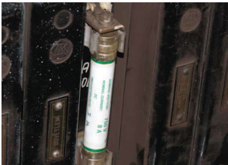
Trhací pojistky v keramickém obalu, později z nehořlavého plastu 8 A 650 V a dalších hodnot, nahradily původní papírové, vysoce hořlavé pojistky ze SSSR.
