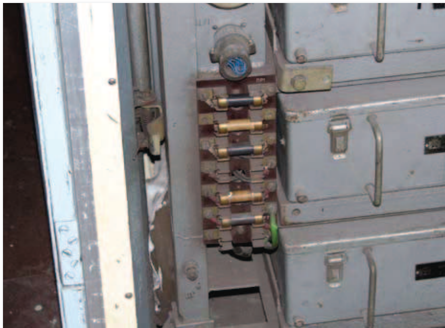
Tyto pojistkové systémy byly plně přezbrojeny pro možnost vyhoření pojistky bez následného požáru ve vozidle. Současně s tím byla vybudována nová pojistková skříň včetně držáků pojistek dle norem ČSN, stejně tak i evropských norem.
