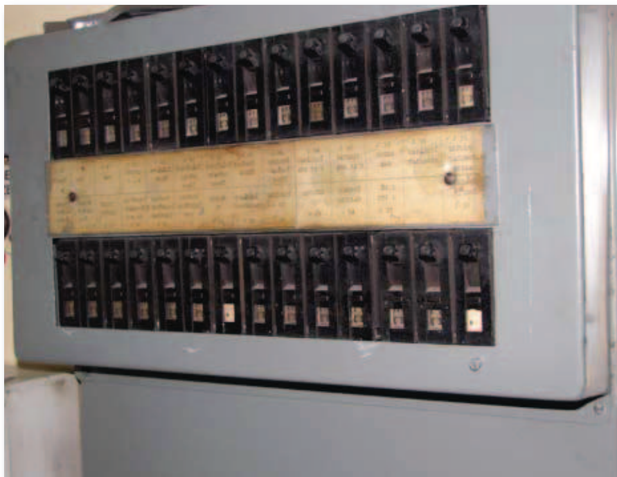
Hlavní pojistkové rozvaděče 220-230 V bylo nutné vyměnit za automatické jističe české výroby, které by zabezpečovaly plynulý provoz soupravy včetně komunikace s řídicím centrem.
