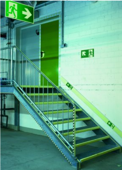
Obrázek 2: Toto schodiště a nouzový východ jsou při evakuaci ve tmě velmi nebezpečné
